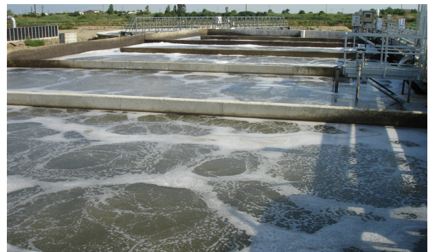
Nitrifikationseinheit mit Tellerbelüftern.
